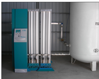
Générateur d'azote relié à la cuve
