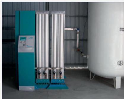
GÉNÉRATEUR D'AZOTE RELIÉ À LA CUVE
